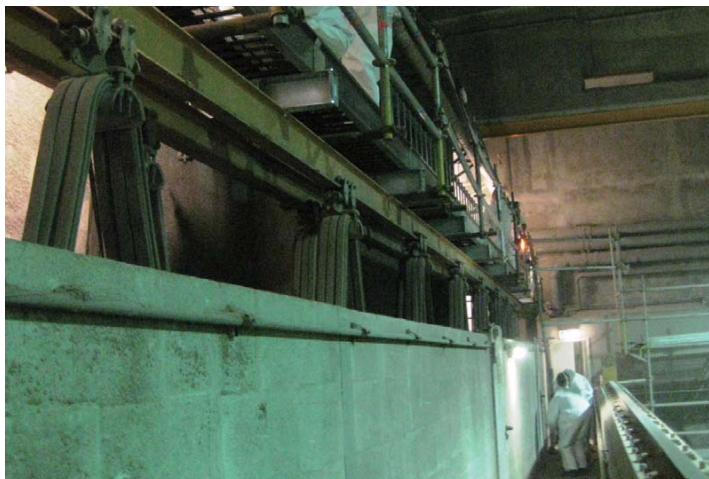
改造前大车使用拖链供电 ...
