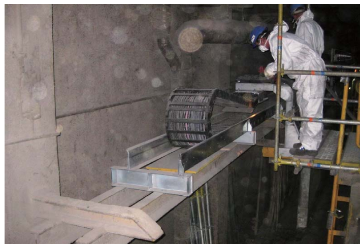
改造后大车使用拖链系统供电 ...
