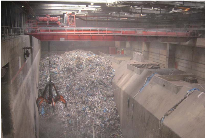
改造前大车使用拖链供电 ...
