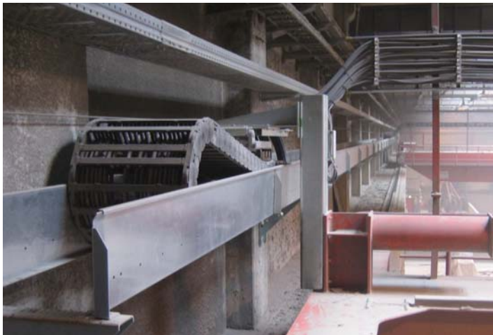
改造后大车使用拖链系统供电 ...
