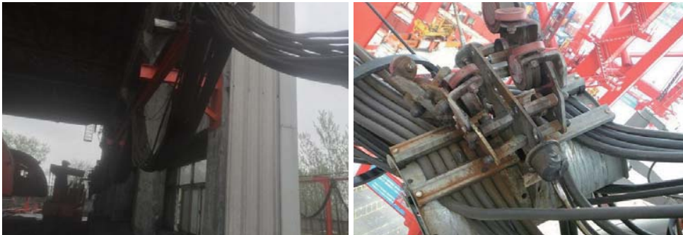
▶ 拖令电缆因受力不均引起起旋（蛇形）
